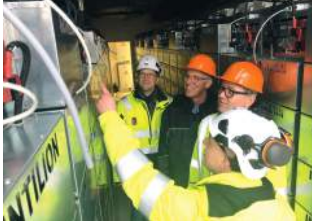
(von hinten nach vorne) Moritz von Barga, Intilion GmbH, verschafft sich mit Stadtwerke Bielefeld Projektleitern Klaus Danwerth und Thorsten Melzer einen Überblick über die bereits erfolgten Arbeiten. Daniel Freymark, Intilion GmbH, zeigt einen von drei Räumen, in dem die Batteriemodule bereits fertig verbaut sind.
